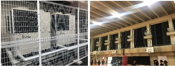
体育館に設置された室外機と空調機
